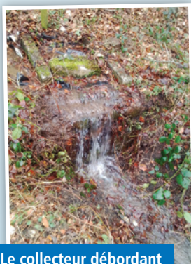
Le collecteur débordant au-dessus de la route
